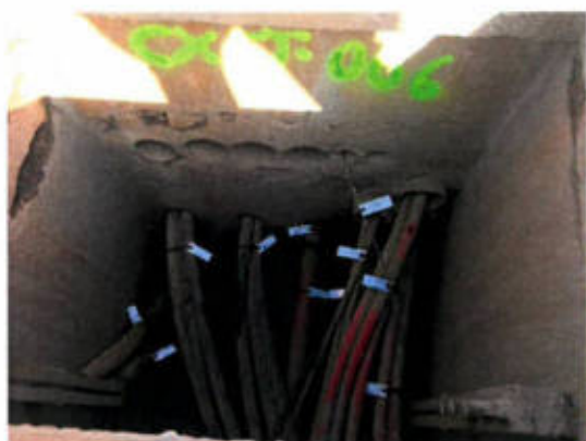
Figura 4 - identificação e etiquetagem de cabos elétricos e telecomunicações
